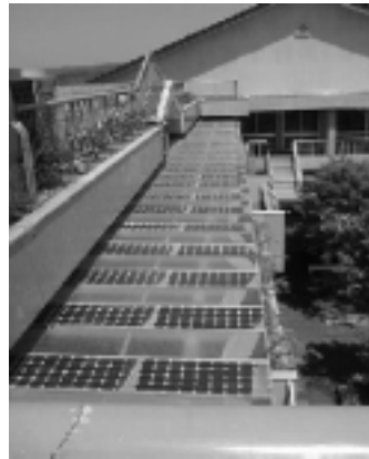
太陽光発電(屋上)
