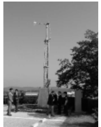
風力発電装置（屋上）
